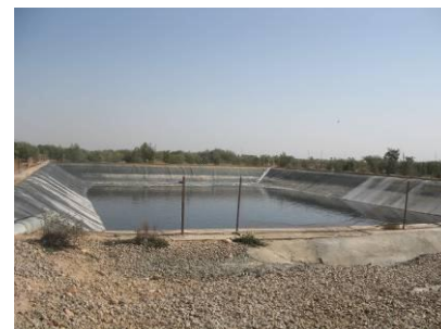
Bassin de récupération des lixiviats
