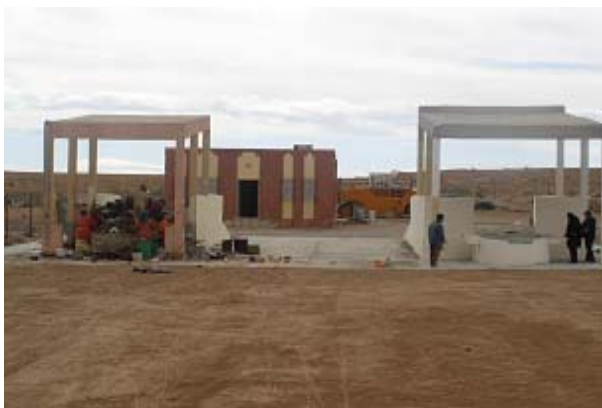
Centre de Co-Traitement (CCT) des déchets de Missour
